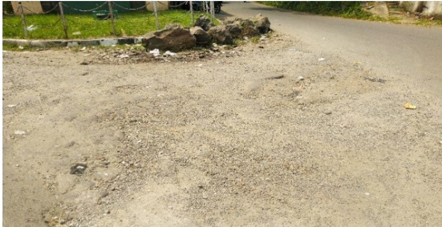
Gambar 3. Kondisi kerusakan jalan pada STA. 0+00(Sumber: dokumentasi pribadi)
