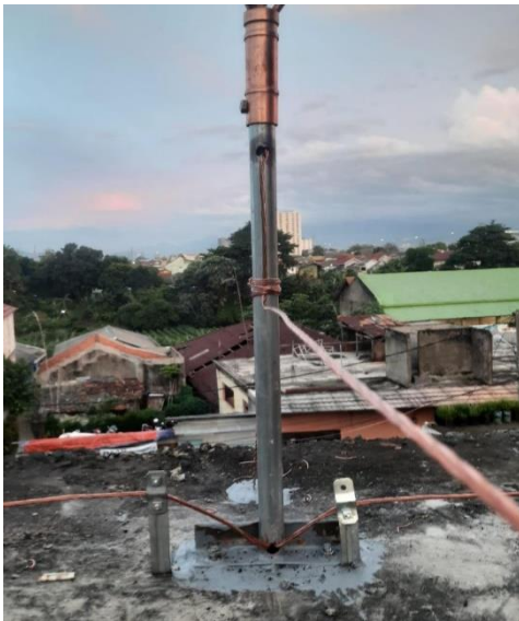
Gambar 3.5 Bentuk fisis down conductor yang terkoneksi dengan terminasi udara
