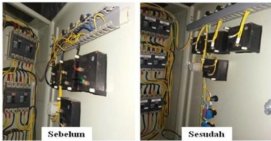
Gambar 13 Tampak dalam pintu LVMDP Fakultas Teknik Gambar 13 memperlihatkan tampak dalam pintu LVMDP Fakultas Teknik dengan ditambah kontrol sistem proteksi UVR/OVR.
