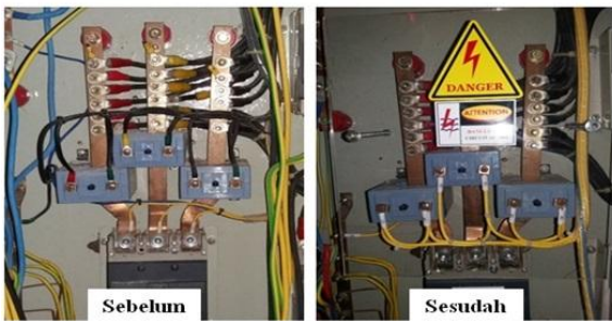
Gambar 12 main busbar LVMDP Fakultas Teknik Seperti yang dapat dilihat pada Gambar 12 Sebelum direkondisi main busbar LVMDP Fakultas Teknik sangat berbahaya karena tidak ada proteksi terhadap main busbar setelah direkondisi main busbar LVMDP Fakultas Teknik ditambahkan akrilik proteksi untuk menahan sentuhan benda terhadap main busbar yang baraliran listrik.
