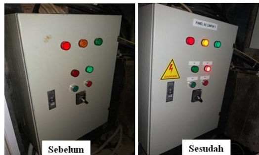
Gambar 16 Tampak depan Panel AC Lantai 1
