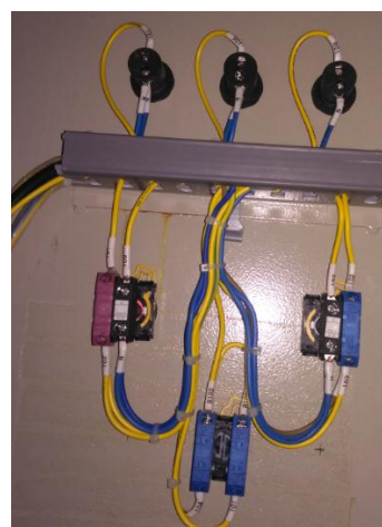
Gambar 22 Pengawatan Photocell pada bagian dalam pintu LVMDP
