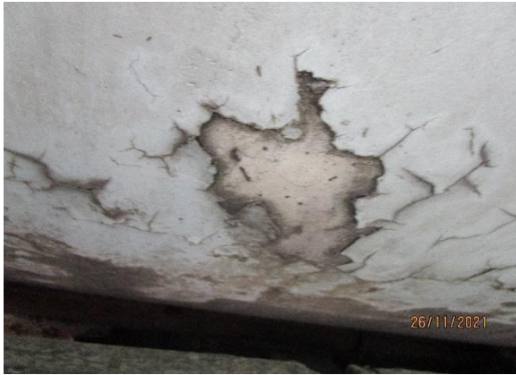
Gambar 3. Under deposit corrosion pada permukaan CNG Buffer Storage Tank
