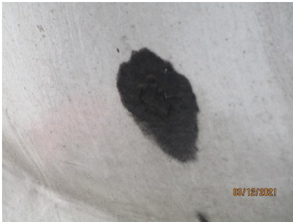
Gambar 4. Uniform corrosion pada permukaan CNG Buffer Storage Tank
