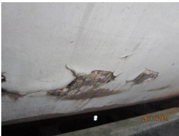
Gambar 5. Uniform corrosion pada permukaan CNG Buffer Storage Tank
