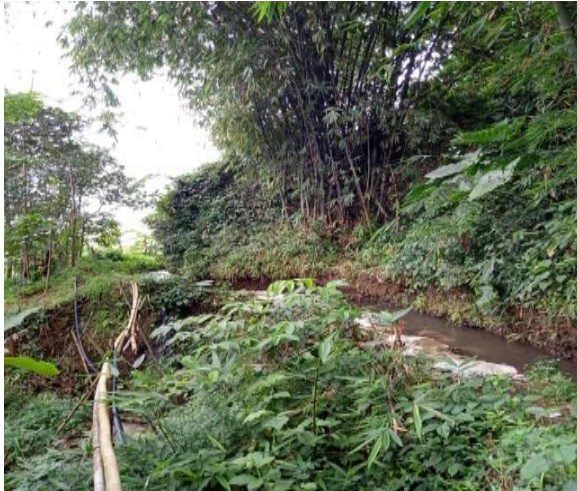
Gambar 1 Kondisi kerusakan DPT
