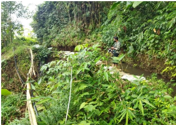
Gambar 5 Kerusakan bagian dasar dinding pengaman
